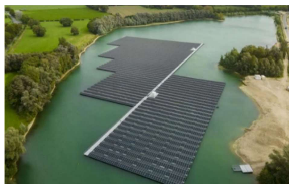
Slika 3.6. Plutajuća solarna elektrana [31]
